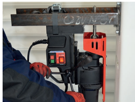
Perforación fuera de posición
