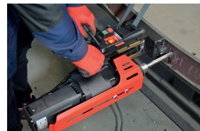
Perforación fuera de posición
